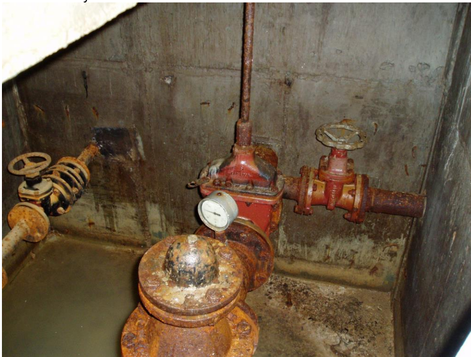
Vzdušnická šachta A717 pohled směrem k potrubí OC DN250, které je umístěno mimo šachtu
