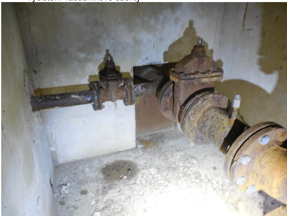
Vzdušnicková šachta A716 pohled směrem k potrubí OC DN350, umístěné mimo šachtu
