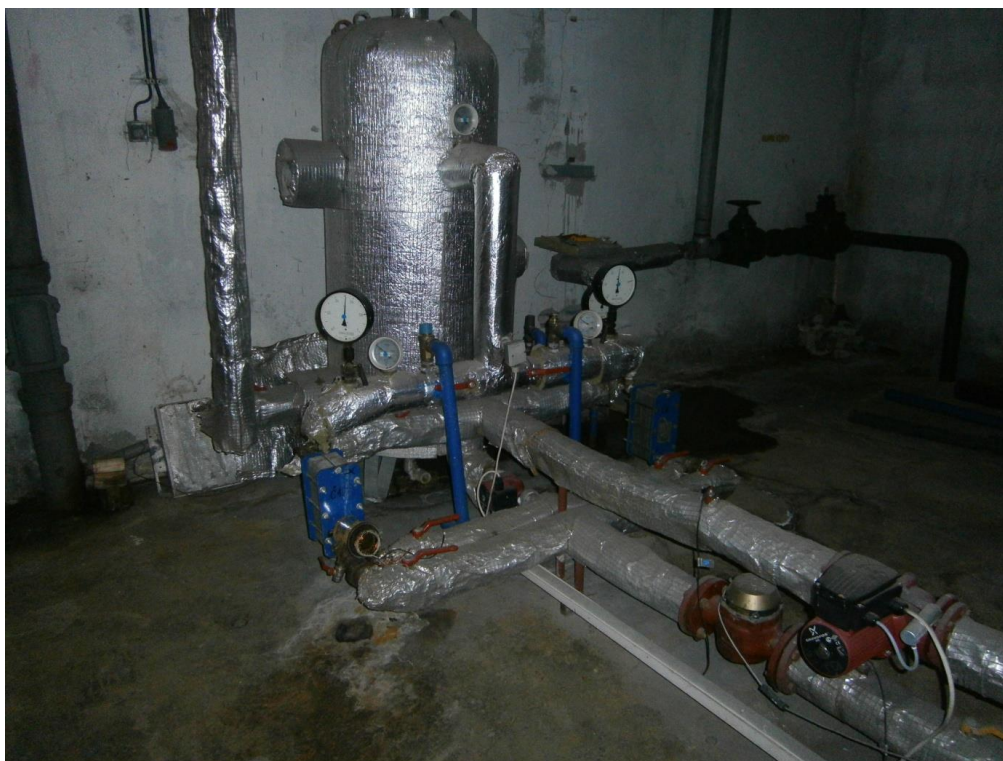
Obr. 3 – Příprava teplé vody na VS H1.
