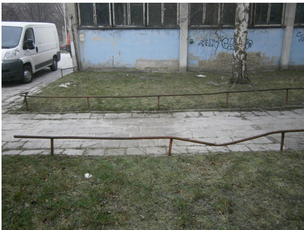
Obr. 6 – Výstup sekundárního potrubí z VS H1.
